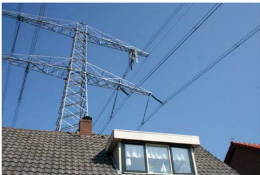
La puissance des champs électromagnétiques est maximale sous le pylône de ligne à haute tension. (Photo : Oostzaan380kv.web-log.nl)
